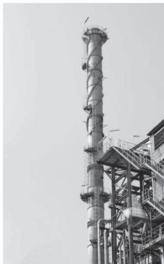
图 7-89 安装扰流装置的塔设备
